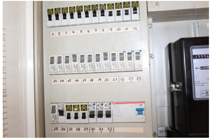
Sicherungskasten mit FI-Schalter
